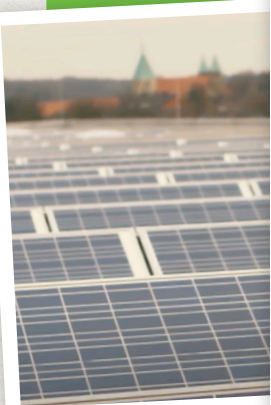
Eine große Fotovoltaik-Anlage stellt auf den Lagerdächern eigene Energie her
